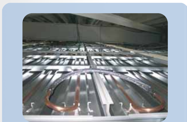
Kühltechnik einer Deckenplatte
