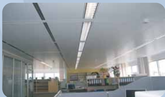
MCC-A.s Bandraster Kühldecke mit Einbauten für Lüftung und Beleuchtung
